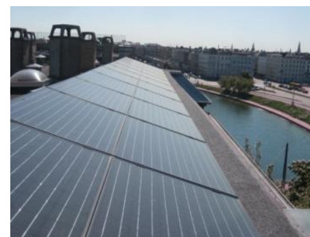
Eksempel på solcelleanlæg
