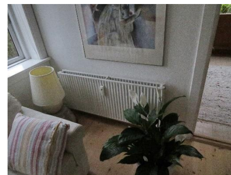
Radiator i lejlighed
