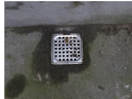
Gulvafløb i kælder
