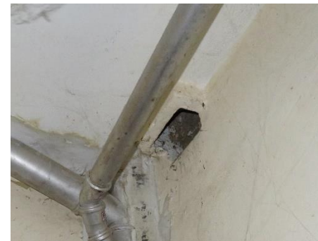
Ventilationskanal i badeværelse
