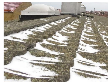
Ståltag med algevækst
