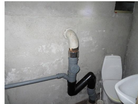
Faldstamme i kælder
