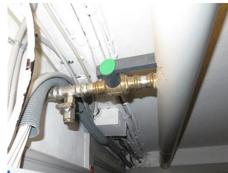
Vandinstallation i kælder
