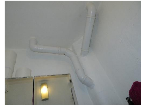
Faldstamme i toilet
